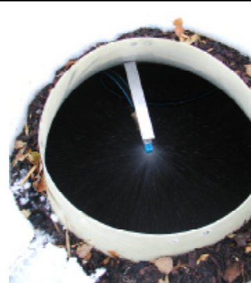
Avloppsvatten sprayas på vertikalfilter vid Ångersjöns rastplats, Hudiksvall
